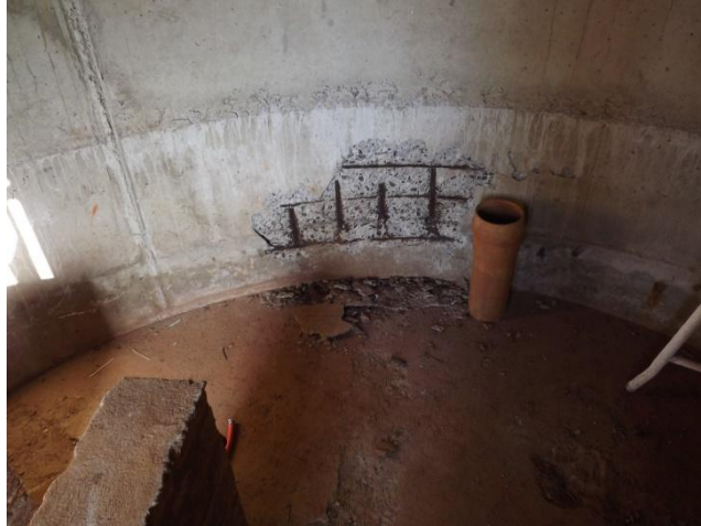
Foto 3.74 – CR COHAB III- REL COHAB III – Armadura exposta.
