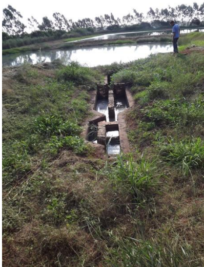
Foto 3.88 – Vista Geral da ETE Nosso Teto.
