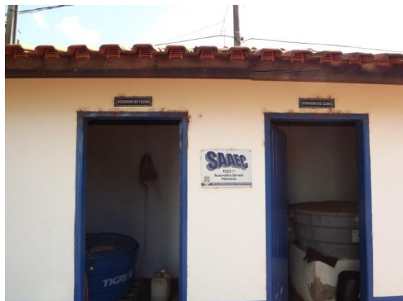
Foto 3.29 – Casa de Química - Dosagem de Cloro e Flúor na área do P11 Patrimônio.
