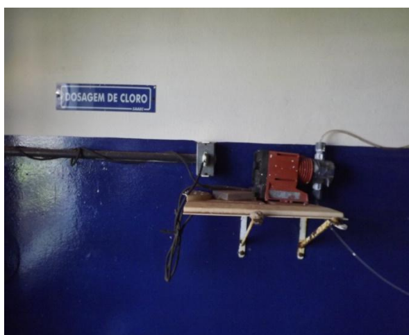
Foto 3.18 – Dosador de Cloro no CR Recinto.
