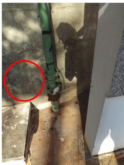
Foto 3.32 – Adutora do P15 COHAB II – Ponto de Aplicação.
