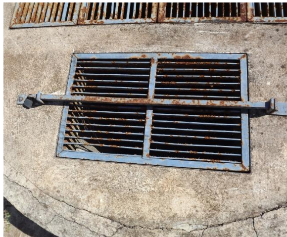
Foto 3.87 - Detalhe da Chegada da Tubulação – Cesto de Retenção.
