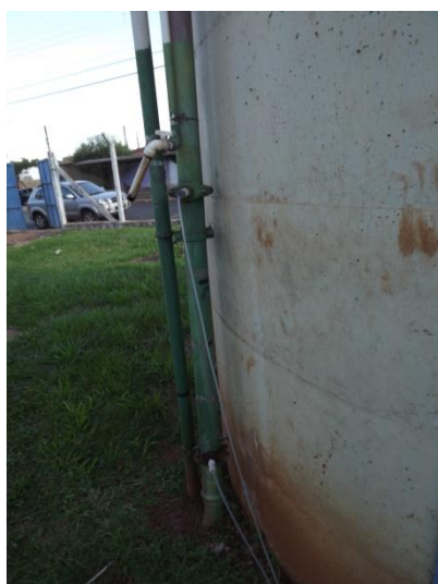
Foto 3.26 – Aplicação de Cloro e Flúor na Adutora do P06.
