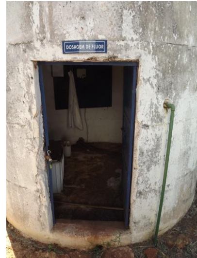
Foto 3.35 – Dosagem de Flúor na Área do Poço Dist. Industrial (Dentro reservatório desativado).
