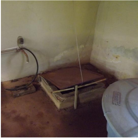
Foto 3.34 – Adutora do P16 Do Grêmio – Ponto de Aplicação.
