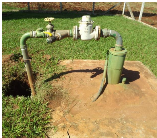
Foto 3.15 – Poço Distrito Industrial.
