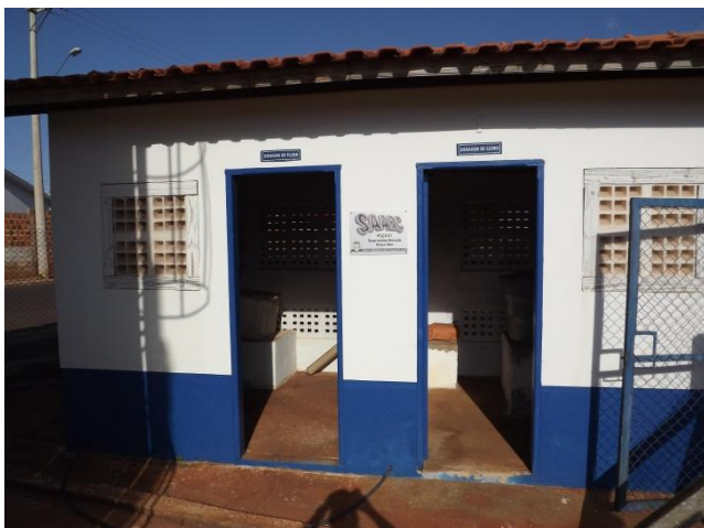
Foto 3.16 – Casa de Química - Dosagem de Cloro e Flúor do P01 Nossa Teto.
