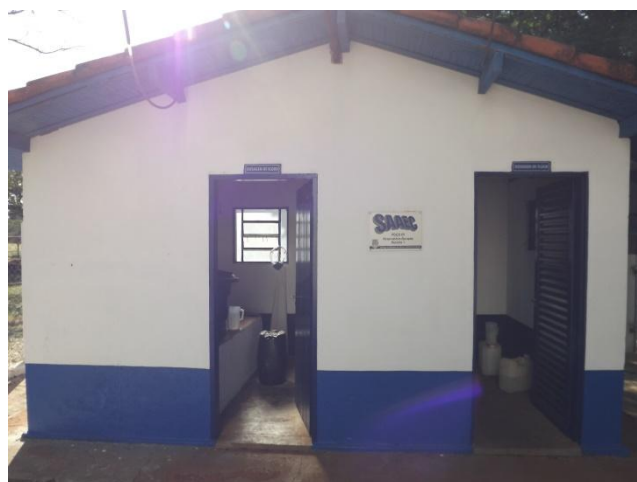
Foto 3.27 – Dosagem de Cloro e Flúor na área do P09 Recinto I.
