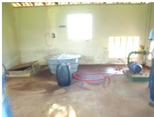
Foto 3.33 – Área de Tratamento do P16 Do Grêmio (Laje do RSE Do Grêmio).
