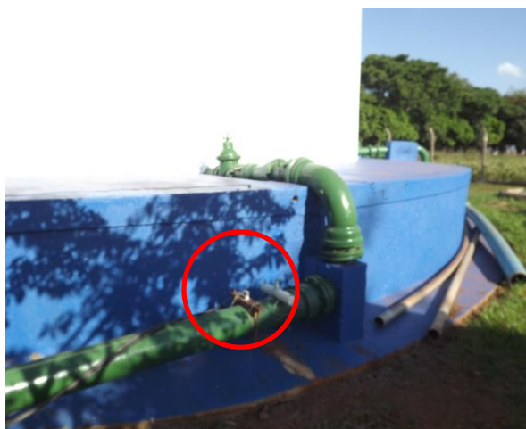
Foto 3.20 – CR Recinto – Ponto de Aplicação na Tubulação de Sucção.
