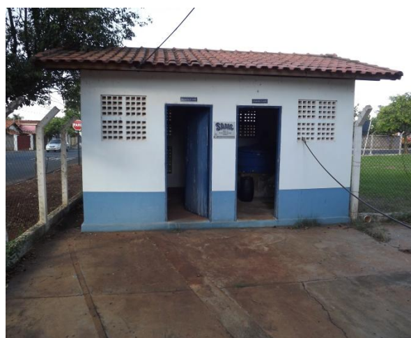
Foto 3.31 – Casa de Química - Dosagem de Cloro e Flúor na área Adutora do P15 COHAB II.
